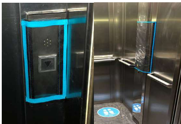
Foto 23 – Dispenser Hall dos elevadores
